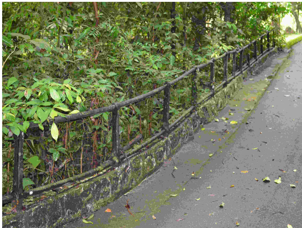
Jambatan berdekatan kolam PBA railing perlu dicat
